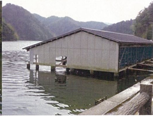
図 6-6 流木で破損した船小屋
