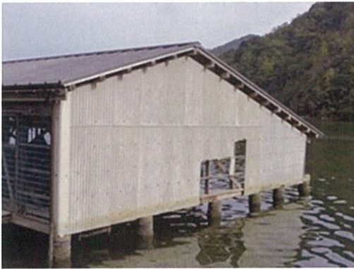
図 6-5 流木で破損した船小屋
